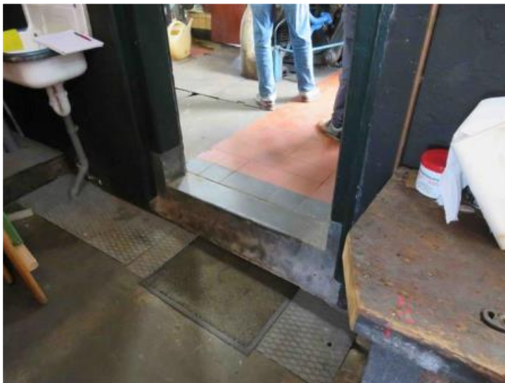
Struikelgevaar bij op- en afstappen bij de tussendeur van de machinehal
