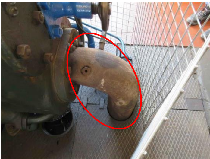
Uitlaatgassenleiding hoofdmotor, hier zonder isolatie
